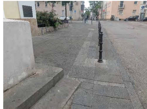
Abbildung 32: Fehlende Kontraste vor der Zwölf-Apostel-Kirche
